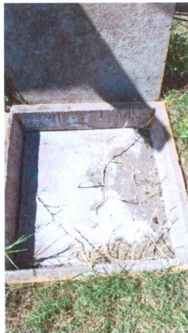
Imagen fotográfica 2. Cámara de inspección del establecimiento
