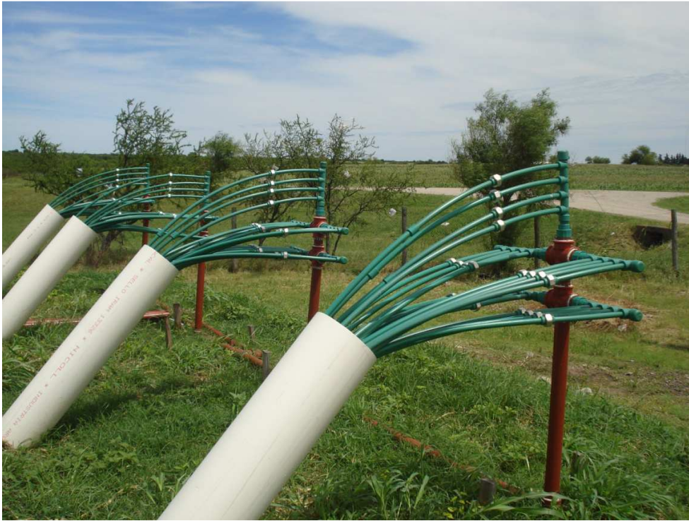
Árboles de distribución y cañería de termofusión \phi 25mm que ingresa a cada cámara del biodigestor.
