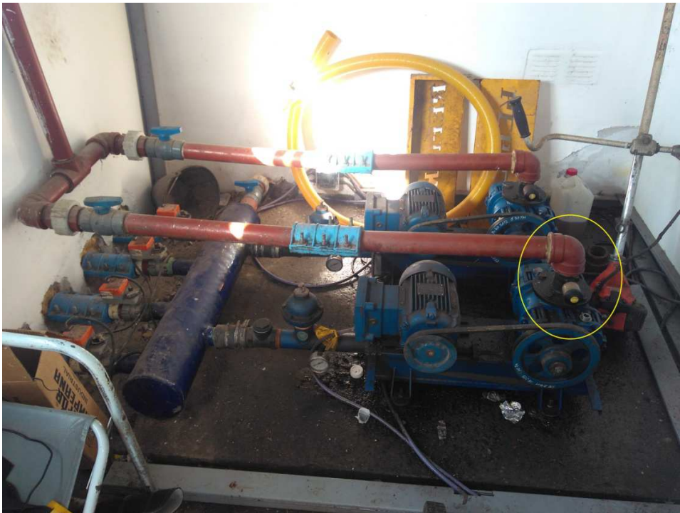
Se observa el ingreso de cañería de \phi 3" , a los equipos compresores, manifold y válvulas con actuadores.
