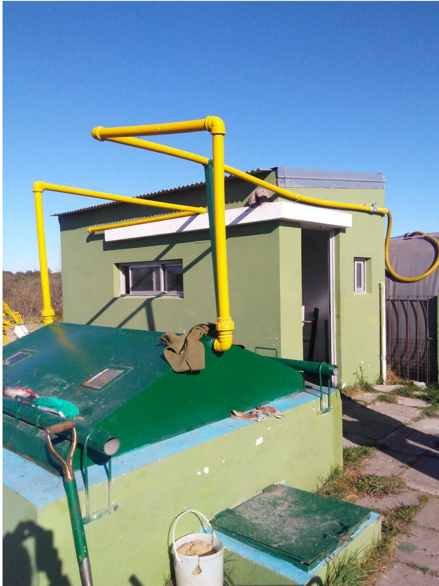
Campana de chapa plegada con dos salidas para la salida de biogás, hacia equipos compresores y tanque bolsa.
